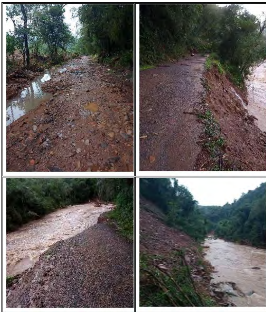
Figura 23. Danos em estradas e acessos.
