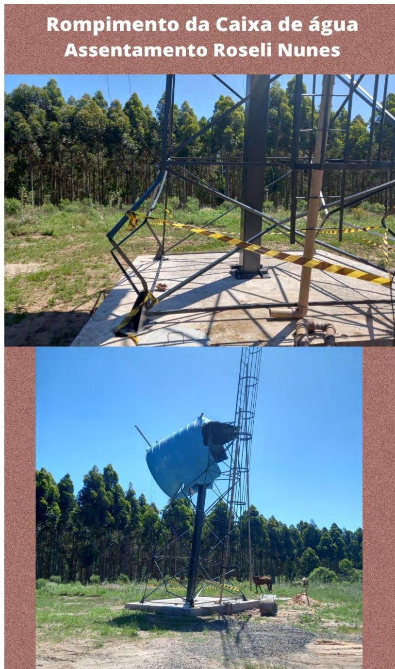
Figura 05: Rompimento caixa de abastecimento de água
