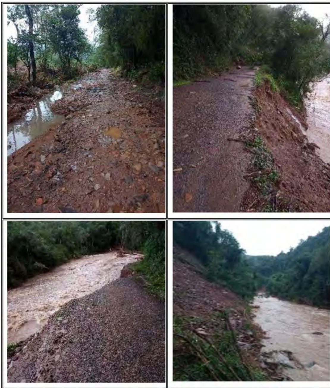
Figura 23. Danos em estradas e acessos.
